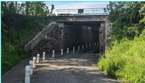
Les défis du franchissement des voies ferrées par les pistes cyclables (passage inférieur rue de Lattre de Tassigny).
