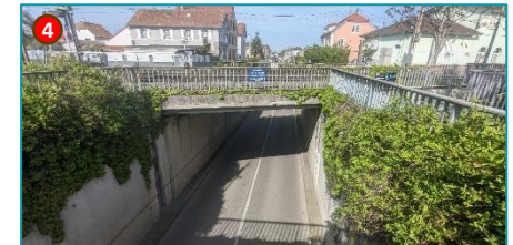
Rue GI De Gaulle – Deux voies de circulation Seul passage au gabarit PL de la commune
