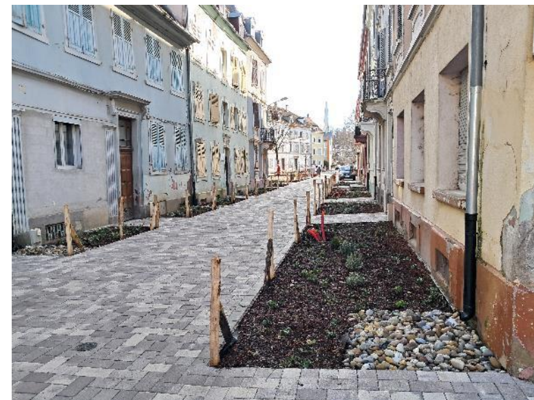
Gouttières coupées + Pavés infiltrants + Noues, Mulhouse
