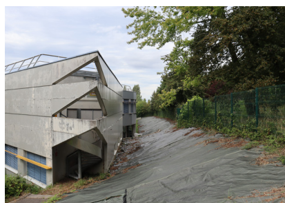
A l'est du site, un talus témoigne de la déclivité de celui-ci
