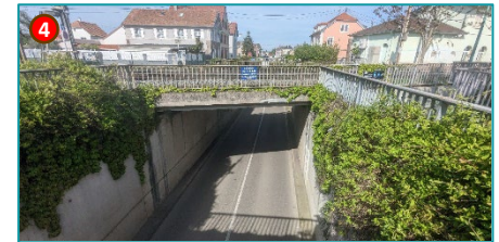
Rue GI De Gaulle – Deux voies de circulation Seul passage au gabarit PL de la commune
