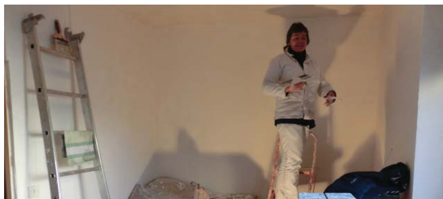
L'insertion (ici un chantier de peinture dans un immeuble mulhousien) peut être un bon moyen de se qualifier et de retrouver un emploi pour les demandeurs d'emploi des quartiers prioritaires.
