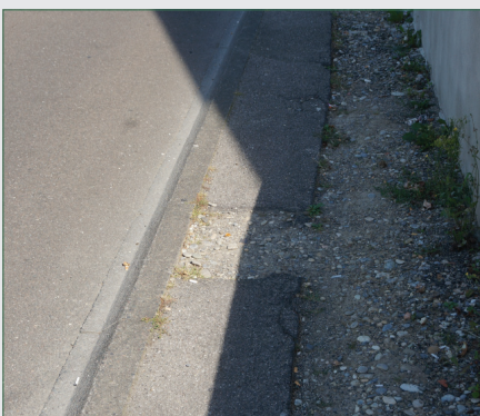
Wittenheim : trou dans trottoir non réparé suite à des travaux.
