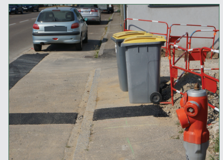
Kingsheim : bouche incendie, poubelles et travaux.
