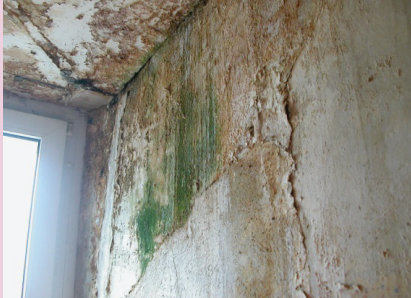
Détail de dégradations de parties communes dans un immeuble des quartiers anciens de Mulhouse (source : Ville de Mulhouse)
