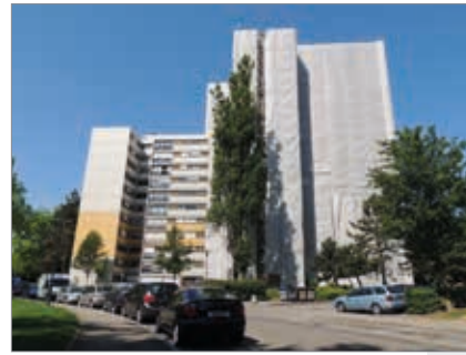
La copropriété Delacroix a bénéficié d'importantes subventions qui lui ont permis de lancer un chantier complet de réhabilitation thermique.
