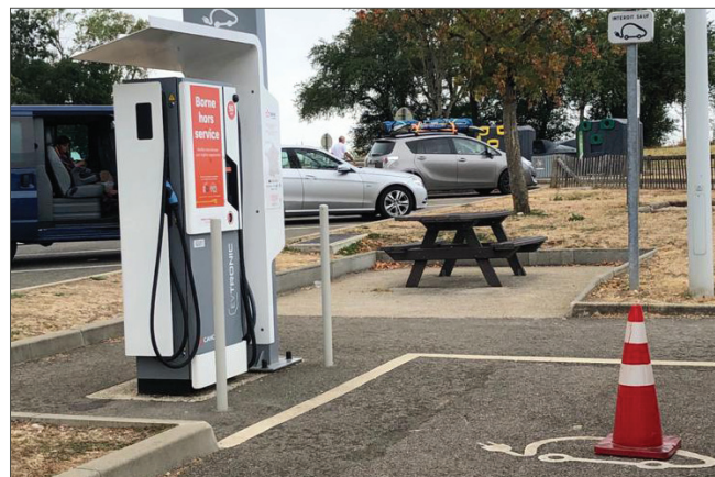
Corri-Door : A 36, août 2020, borne de recharge mise hors service.
