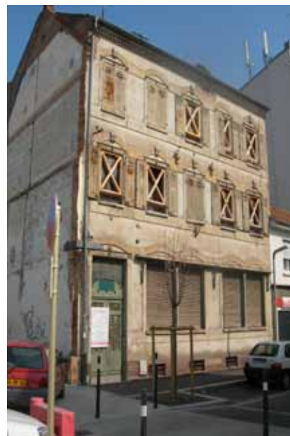
Franklin – Immeuble condamné rue du Gaz
