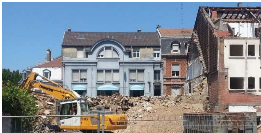
Dans le quartier Briand, la démolition de l'îlot "Safi-Lojink" s'achève. Un espace associatif dédié au sport va bientôt remplacer des entrepôts artisanaux et commerciaux.
