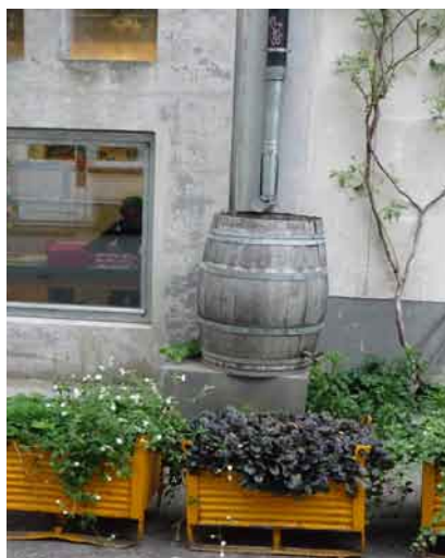
Système de récupération des eaux pluviales de toiture à moindre frais et à utilisation immédiate à Basel dans le Gundeldinger Feld (CH).
